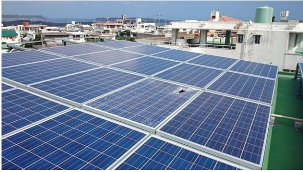
【パネルの破損】
